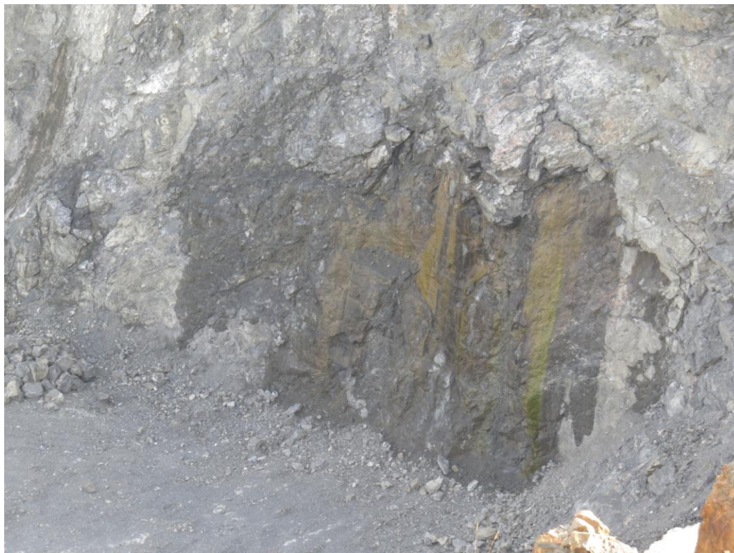
Obr. č. 3. Vlhnutí v jv. části stěny na 3. etáži.
